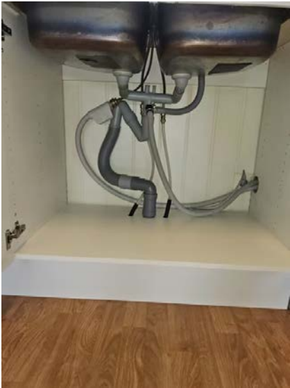
Bilde viser rørplegg under oppvaskkum.
