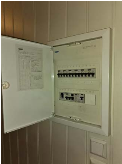
Bilde viser sikringsskap.
