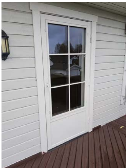
Bilde viser balkongdør.
