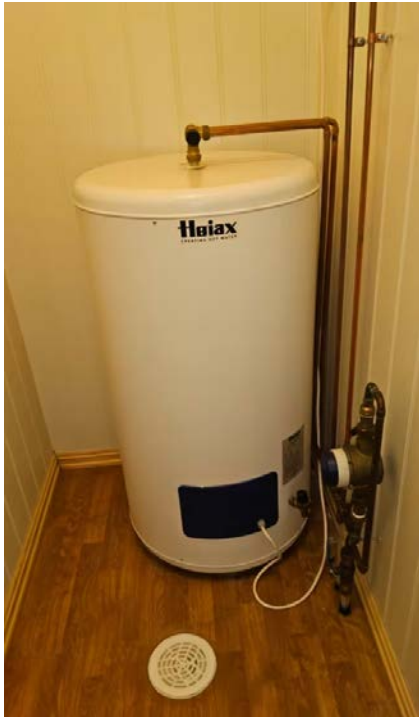
Bilde viser varmtvannsbereder.
