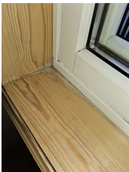
Bilde viser fuktskjolder i utforing.
