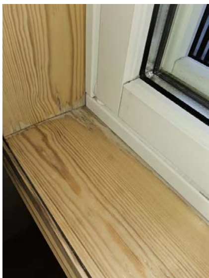
Bilde viser fuktskjolder i utforing.
