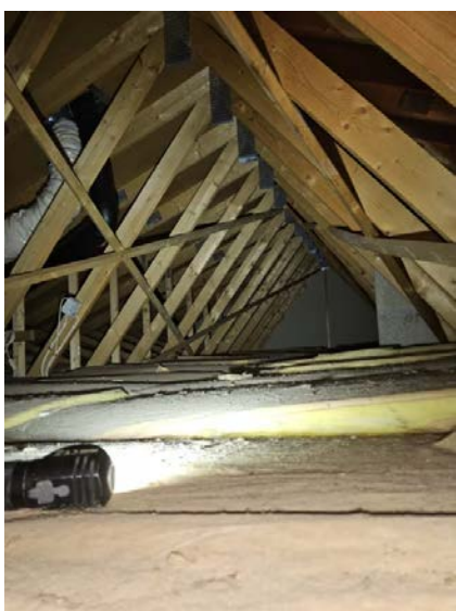
Bilde viser kaldtloft.
