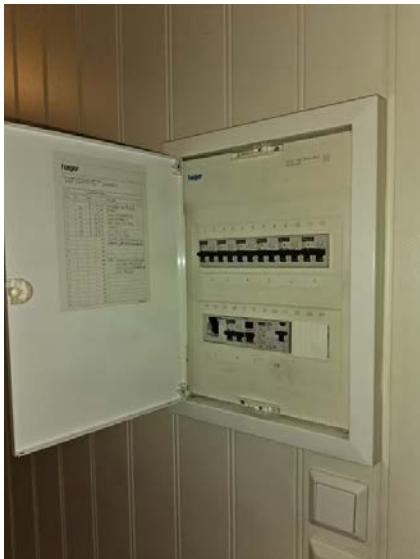
Bilde viser sikringsskap.
