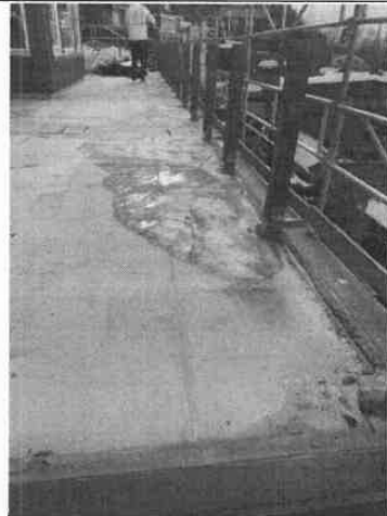
Bilde viser issvull der hvor vannet hadde trengt ned i hovedsoverrommet.
