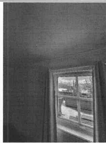
Bilde viser himlingen inne på hovedsoverrommet til huseier. Dette var en av stedene vannet hadde trengt igjennom konstruksjonen.
