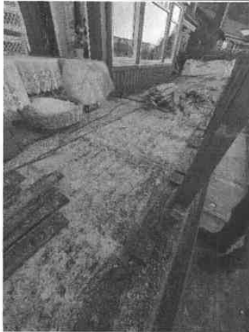
Bilde viser issvull under terrassegulvet der hvor vannet hadde trengt ned i hovedsoverrommet.
