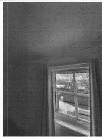
Bilde viser himlingen inne på hovedsoverrommet til huseier. Dette var en av stedene vannet hadde trengt igjennom konstruksjonen.
