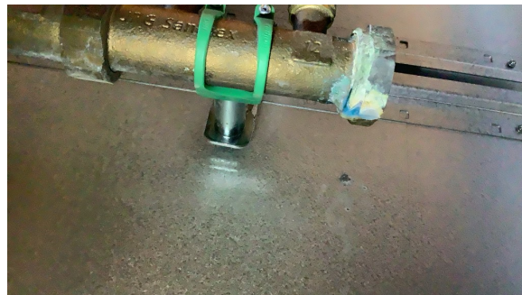
Kupling "svetter" i rørskap.
