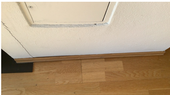
Det er ikke ubrennbart materiale på gulv under sotluke.
