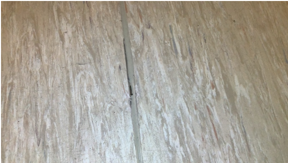
Sprekk i sveiseskjøt.
