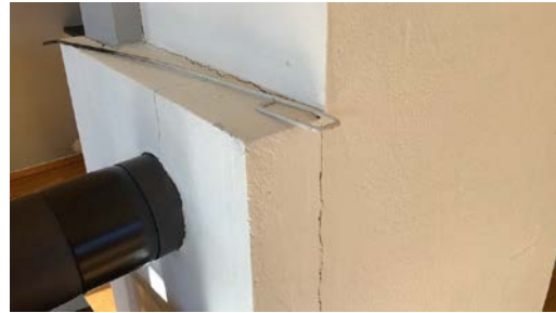
Sprekker i ubrennbare plater og i overgang mot pipe.
