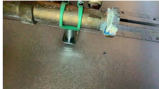
Kupling "svetter" i rørskap.
