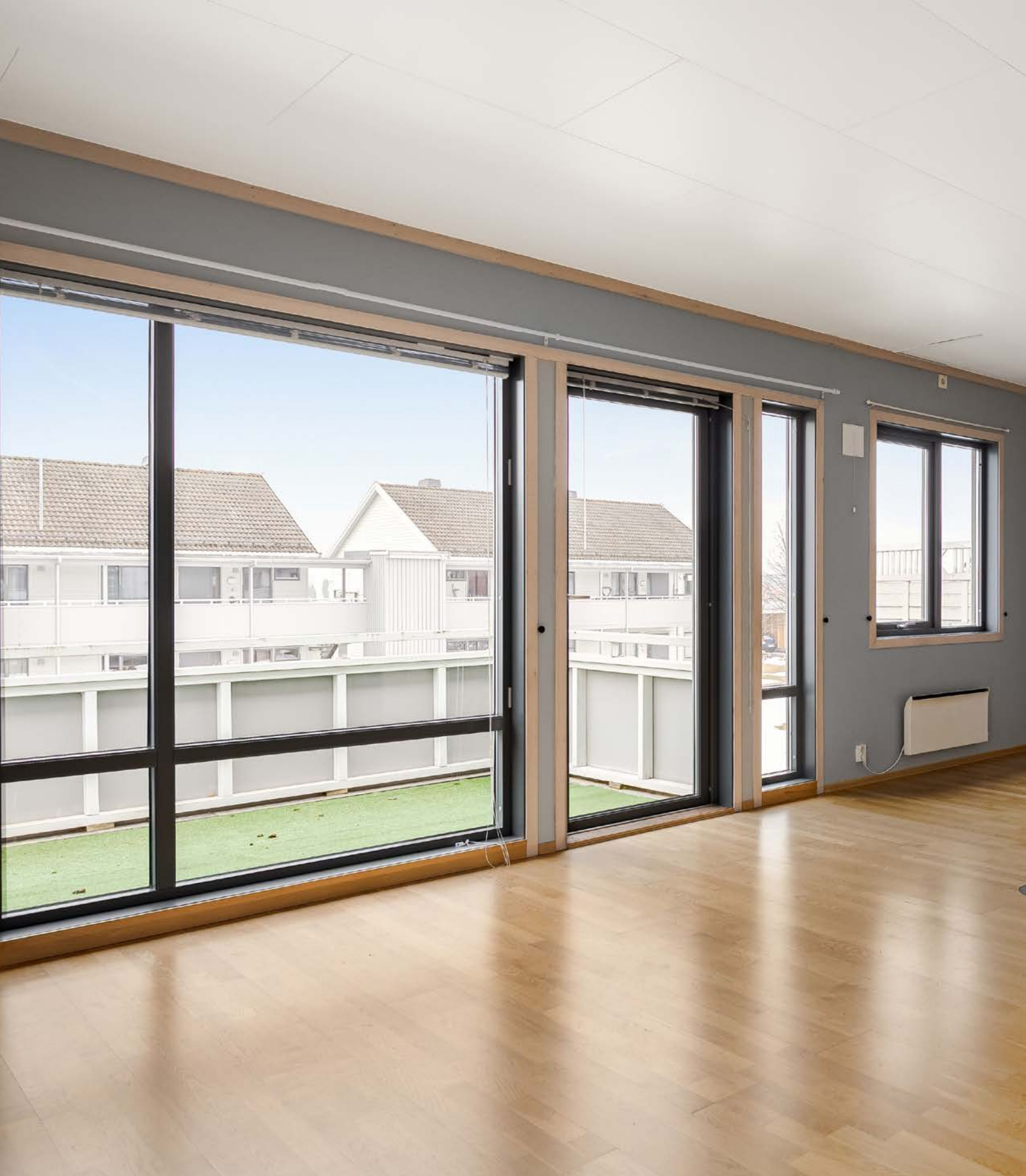
Balkongdør i tre med 2-lags isolerglass.
