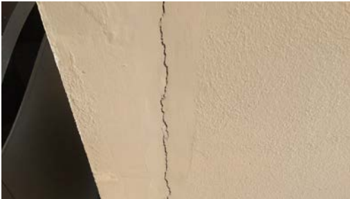
Sprekk i overgang mellom ubrennbar plate og pipe.
