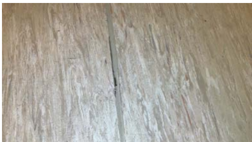
Sprekk i sveiseskjøt.
