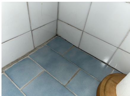
Eksempel på oppsprekking mellom fliser på gulv og vegg.
