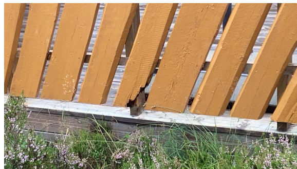
Eksempel på råte i kledningsbord på rekkeverk.
