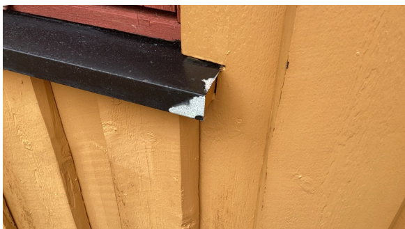
Eksempel på avskaling på beslag
