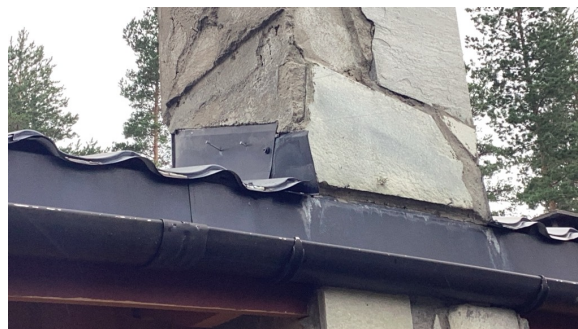
Overgangsbeslag på piper kan være sårbare punkter med tanke på lekkasjer og det er viktig å følge med på dette.
