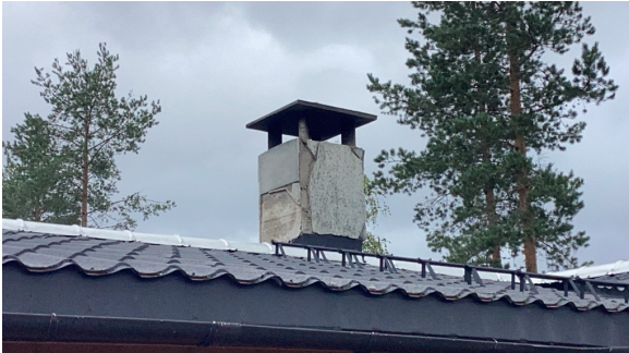
Skiferstein har løsnet fra pipe.
