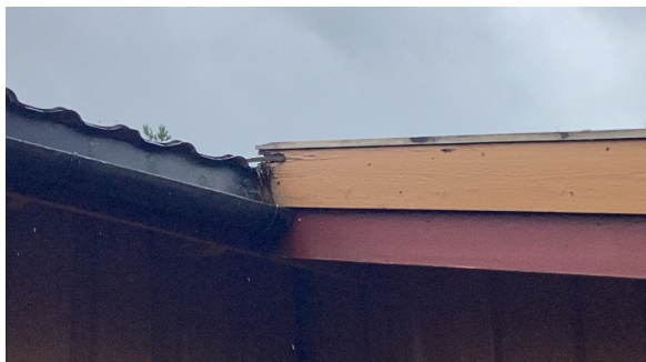
Råte på vindski.
