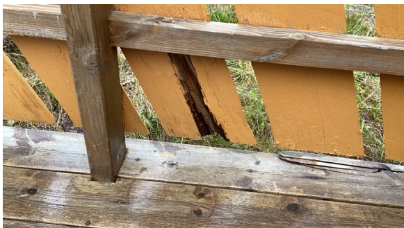
Eksempel på råte i kledningsbord på rekkeverk.
