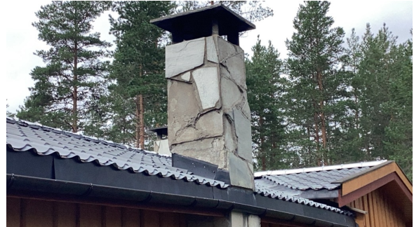
Skiferstein har løsnet fra pipe.
