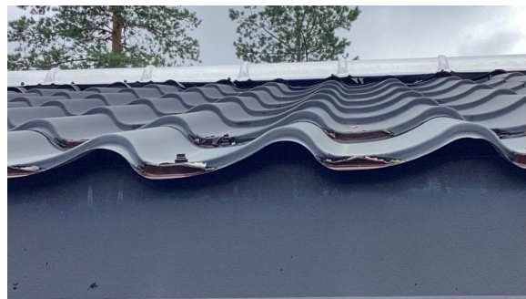
Stedvis avskaling og rust på kanter på takplater
