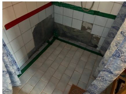
Utett våtrom. Vannlekkasje fra dusj til kjeller.
