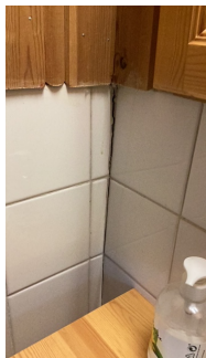
Eksempel på oppsprekking mellom fliser på vegg.
