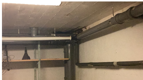
Fuktskade i himling i hjørne.
