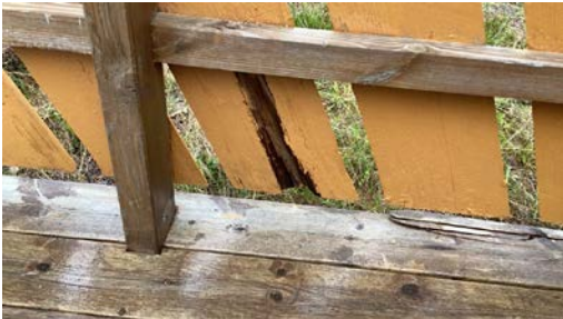
Eksempel på råte i kledningsbord på rekkverk.
