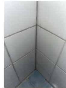
Eksempel på oppsprekking mellom fliser på vegg.
