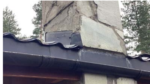
Overgangsbeslag på piper kan være sårbare punkter med tanke på lekkasjer og det er viktig å følge med på dette.
