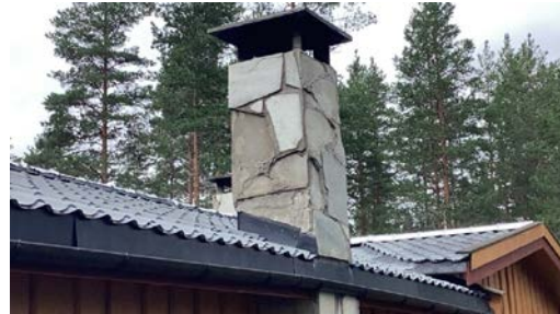
Skiferstein har løsnet fra pipe.
