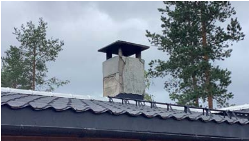
Skiferstein har løsnet fra pipe.
