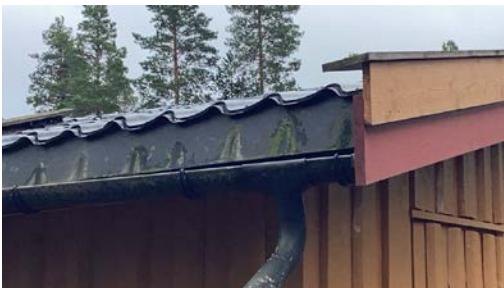
Eksempel på misfarging.
