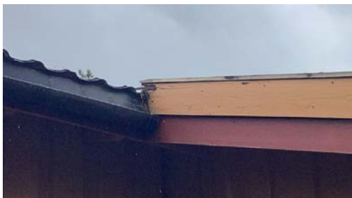
Råte på vindski.
