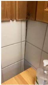
Eksempel på oppsprekking mellom fliser på vegg.
