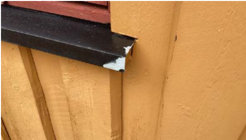
Eksempel på avskaling på beslag
