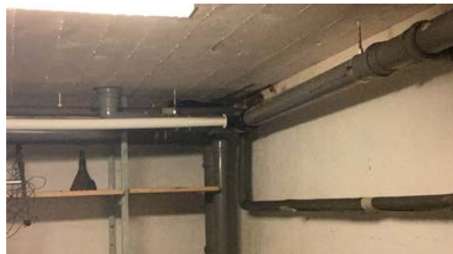
Fuktskade i himling i hjørne.
