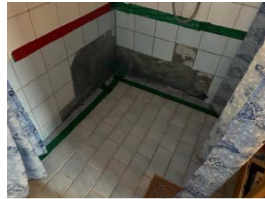
Utett våtrom. Vannlekkasje fra dusj til kjeller.
