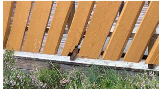
Eksempel på råte i kledningsbord på rekkverk.
