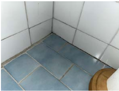
Eksempel på oppsprekking mellom fliser på gulv og vegg.
