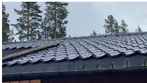
Skjevhet på konstruksjonen i overgang mot utvendig bod.
