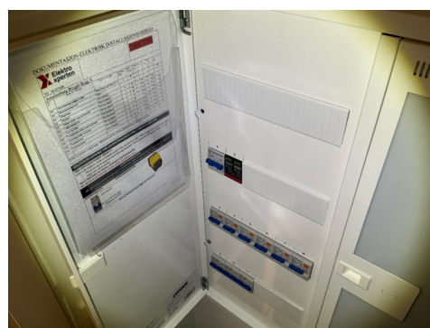
Sikringsskap minste delen
