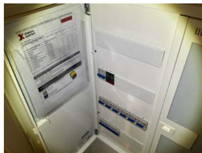
Sikringsskap minste delen
