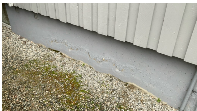
Avskalling på grunnmur.
