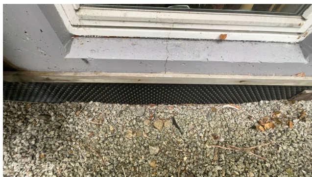
Sprekk i grunnmur under et kjellervindu.
