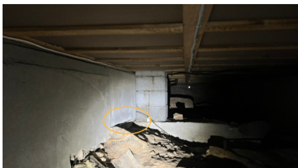
Eksempel på utvasking av masser under fundamenter
