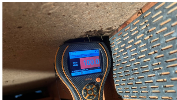
Fuktsøk ved referansemålingen
