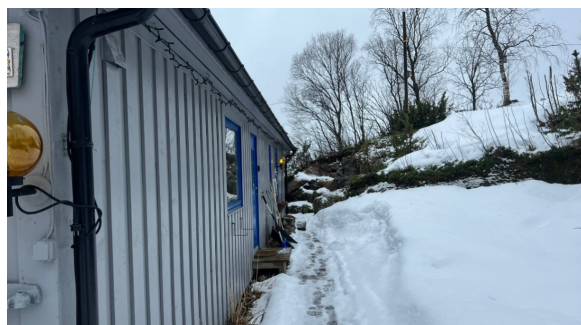
Terrenget faller mot boligens bakside
