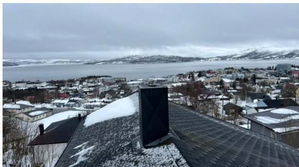
Feil inntekking av pipebeslag øker risiko for vanninntregning
