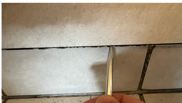
Manglende fuge i nedkant av veggplate
