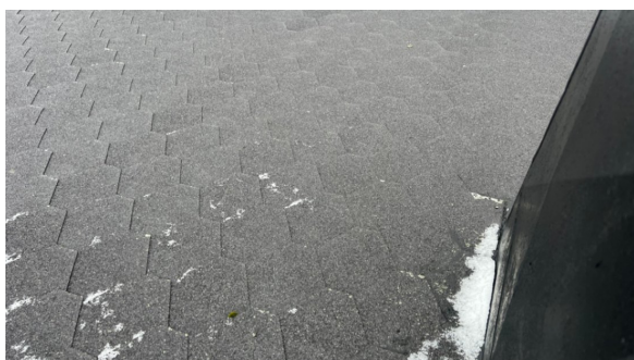
Feil inntekking av pipebeslag øker risiko for vanninntregning
