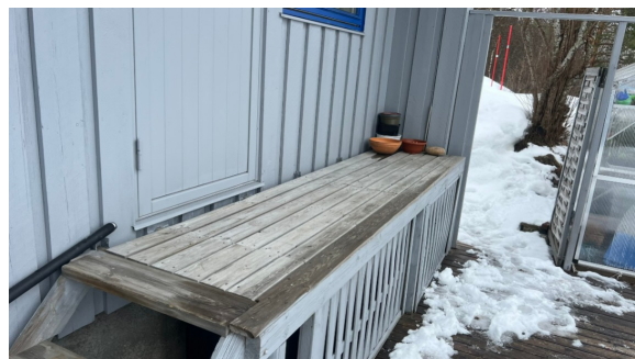
Manglende rekkverk på veranda.
