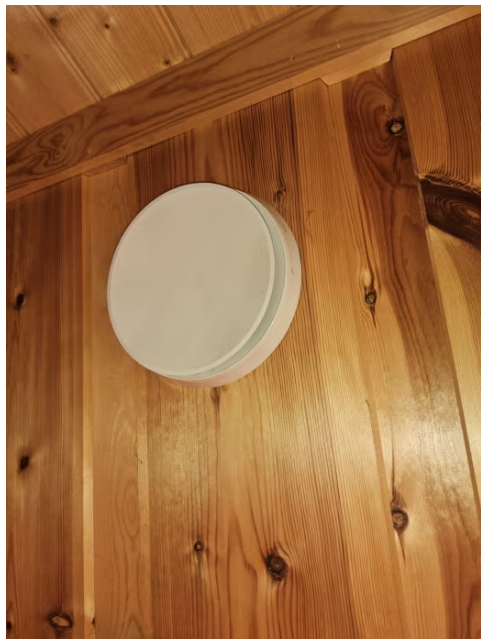
Bilde viser lufteventil.
