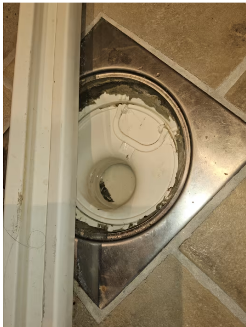
Bilde viser sluk.
