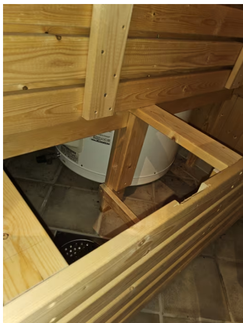
Bilde viser varmtvannsbereder.
