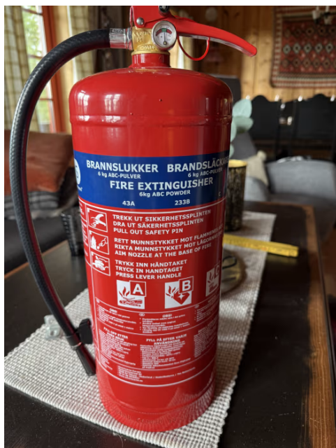
Bilde viser brannslukningsapparat.
