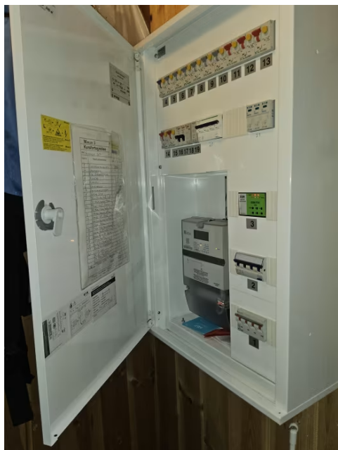
Bilde viser sikringsskap.
