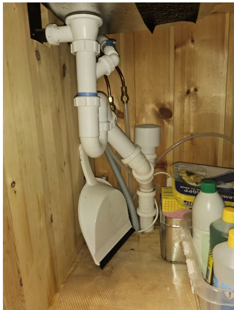
Bilde viser røropplegg under oppvaskkum på kjøkken.
