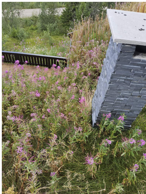
Bilde viser manglende takstige.
