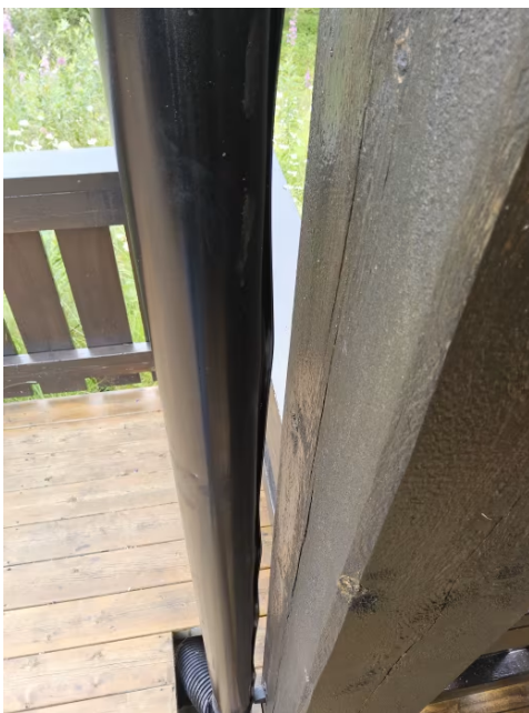
Bilde viser buling i taknedløp.
