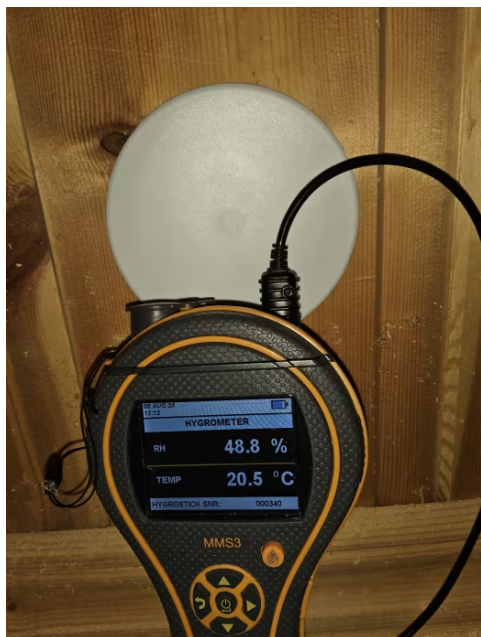
Bilde viser fuktmåling.
