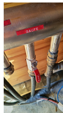
Stoppekran inne i pumpehus. Aktuell kran er merket Gaute.
