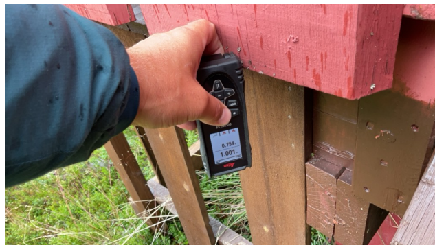
Høyde til terreng 0,5 m og tilstrekkelig rekkverkshøyde kreves
