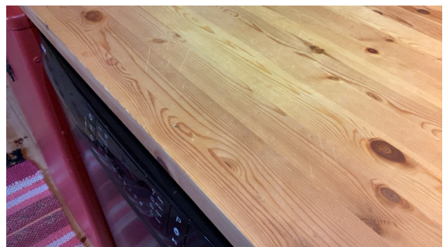
Slitasje på benkeplate
