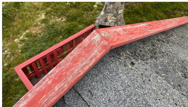
Slitasje på isbord
