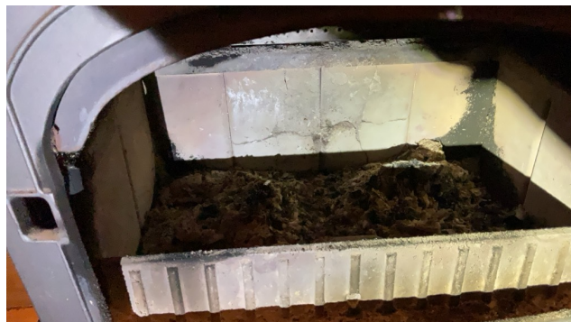
Sprekker i ildfaste steiner i vedovn
