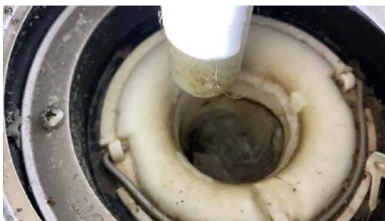
Fra sluk var det ikke synlig tettesjikt under klemring
