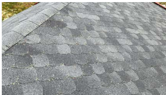
Mosedannelse på tekking, må hensyntas alder
