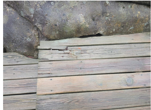
Skade i terrassebord.
