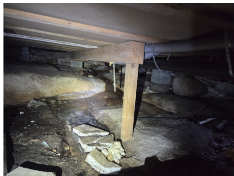
Søylen på bildet bør monteres i en søylesko, slik at treverk løftes opp fra bakkeniva.
