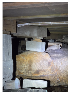
Fundmanetering og anlegg for dragere er ikke fagmessig utført. H
