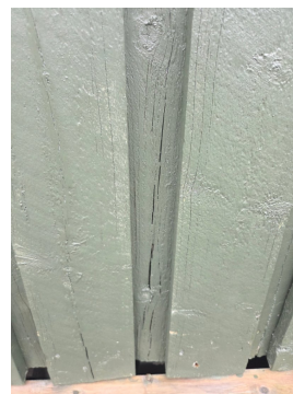
Sprekkdannelser i kledningsbord.
