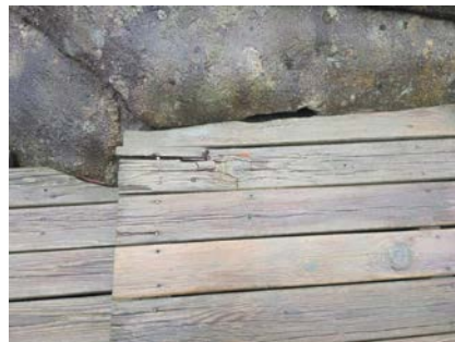
Skade i terrassebord.
