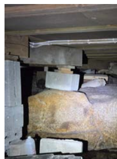
Fundamentering og anlegg for drager er ikke fagmessig utført. H
