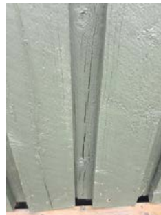
Sprekke i kledningsbord.
