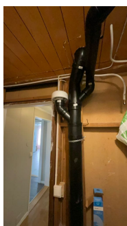
Det er ikke påvist tilfredsstillende lufting av avløpsanlegget.
