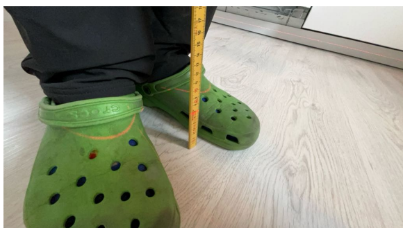
Helningsavvik på 23 mm ble målt i kjøkken.
