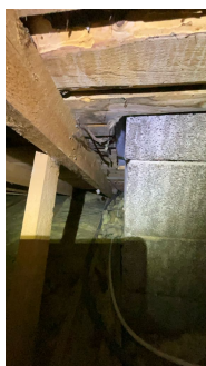
Pipe er ikke pusset som anbefalt.
