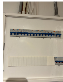
Sikringskap for utleiedel plassert i bod i underetasje.
