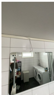
Løs ledning til spei på bad i utleiedel.
