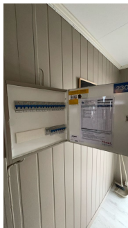
Sikringskap for hoveddel plassert i 1. Etasje
