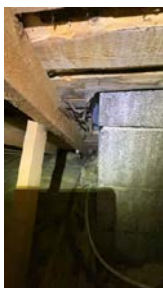
Pipe er ikke pusset som anbefalt.
