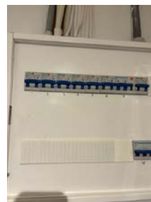
Sikringskap for utleiedel plassert i bod i underetasje.
