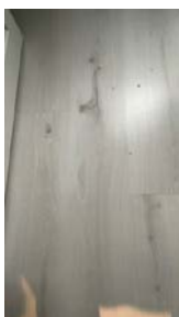
Gulv er feilmontert enkelte steder.
