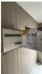
Sikringskap for hoveddel plassert i 1. Etasje
