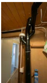
Det er ikke påvist tilfredsstillende lufting av avløpsanlegget.
