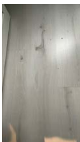
Gulv er feilmontert enkelte steder.
