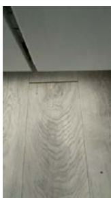
Kortskjøt på laminatgulv har sklid fra hverandre.
