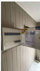
Sikringskap for hoveddel plassert i 1. Etasje
