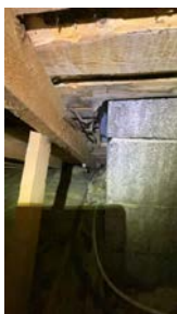
Pipe er ikke pusset som anbefalt.
