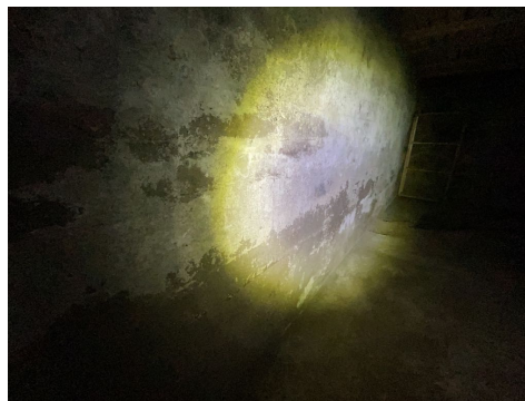
Saltutslag på grunnmur
