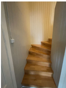
Det mangler håndløper på vegg i trapp.
