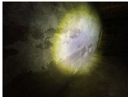
Saltutslag på grunnmur
