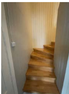
Det mangler håndløper på vegg i trapp.
