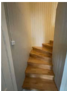
Det mangler håndløper på vegg i trapp.
