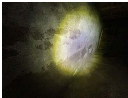
Saltutslag på grunnmur
