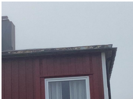
Eksempel på avskaling på beslag.
