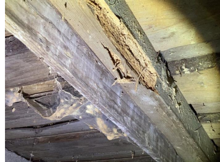
Råteskade i bjelke under kjøkken.
