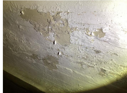
Eksempel på avskaling på vegger.
