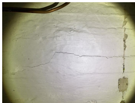
Eksempel på innvendig sprekk i grunnmur.
