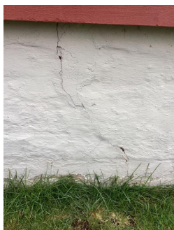
Eksempel på utvendig sprekk i grunnmur.
