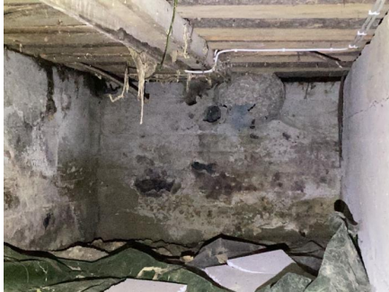
Kryperom under kjøkken.
