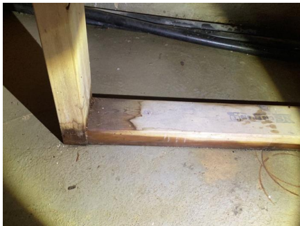
Fuktpåkjenninger på understøttelse av tre.
