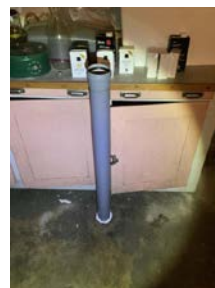
Eksempel på rør som kommer opp fra gulv.
