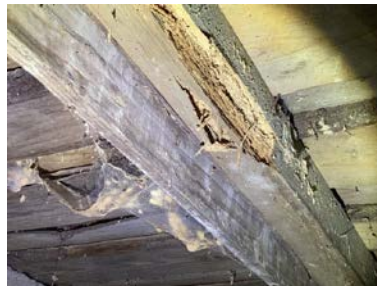
Råteskade i bjelke under kjøkken.
