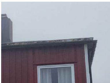
Eksempel på avskaling på beslag.
