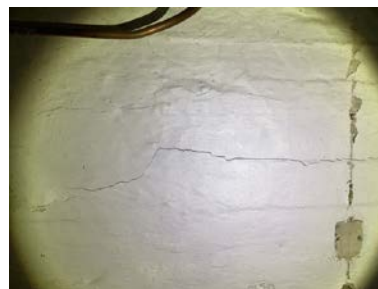
Eksempel på innvendig sprekk i grunnmur.
