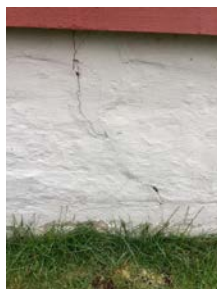
Eksempel på utvendig sprekk i grunnmur.
