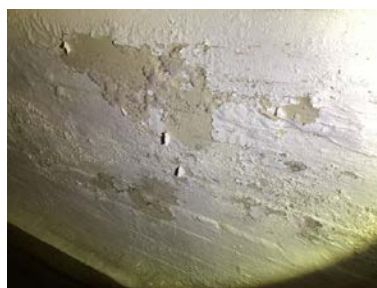
Eksempel på avskaling på vegger.
