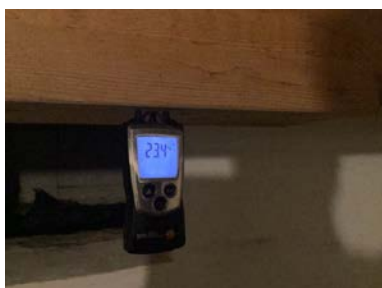
Fuktinnhold i treverk i kjeller på over 20 vektprosent.
