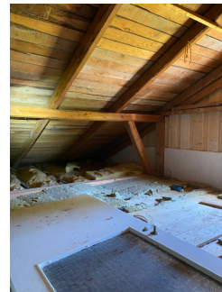
Delvis tett mellom isolasjon og undertak på enkelte steder.
