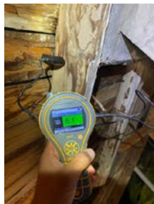
Ingen unormale verdier rundt fuktskjolder i treverk.
