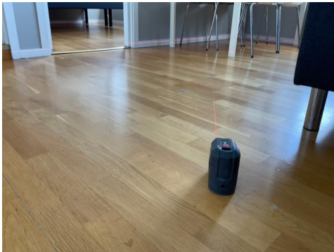
Nivellering stue/kjøkken, avvik ca. 10-20 mm
