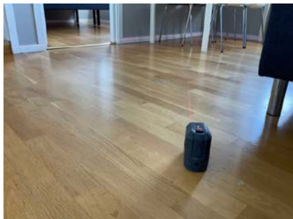
Nivellering stue/kjøkken, avvik ca. 10-20 mm
