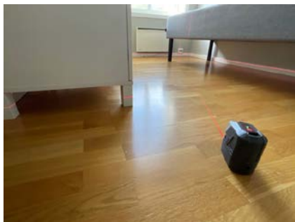
Nivellering soverom, avvik ca. 10-20 mm
