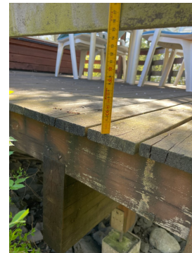
Åpning over 10 cm mellom horisontale spiler
