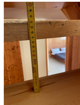
Åpning over 10 cm mellom trappetrinn
