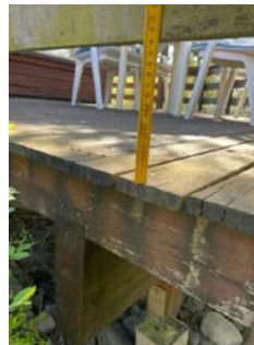
Åpning over 10 cm mellom horisontale spiler
