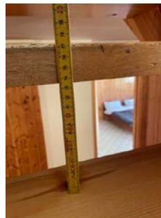
Åpning over 10 cm mellom trappetrinn
