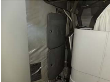
Varmtvannsbereder er plassert i kjøkkeninnredning.
