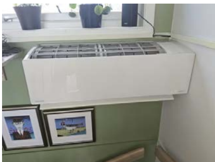
Varmepumpe er plassert i trappegang.
