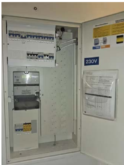
Sikringsskap er plassert i gang.
