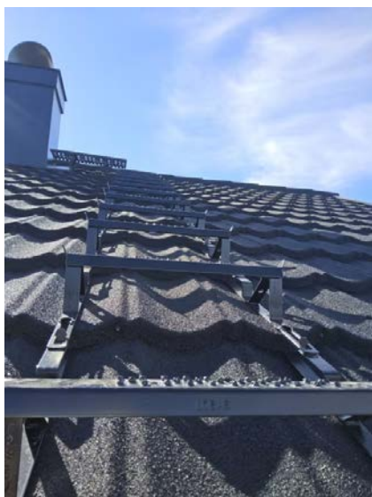
Det er etablert takstige til pipe.
