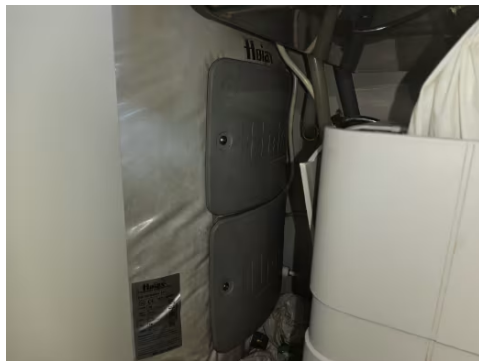
Varmtvannsbereder er plassert i kjøkkeninnredning.
