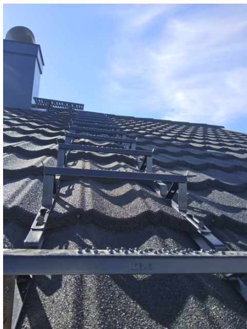
Det er etablert takstige til pipe.
