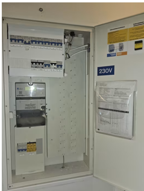
Sikringsskap er plassert i gang.
