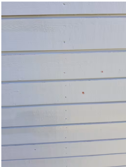
Bilde viser festemidler som er ført for langt inn i kledningen.
