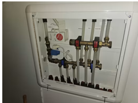
Fordelerskap for rør-i-rør er plassert i gang.
