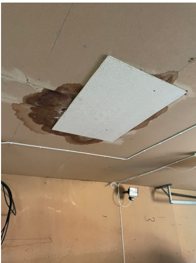
Skader som følge av lekkasje fra tak
