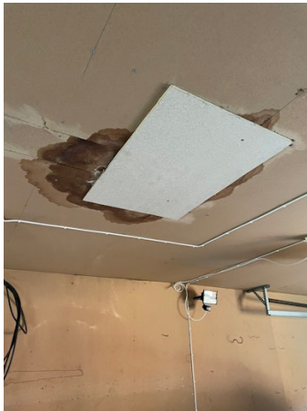
Skader som følge av lekkasje fra tak
