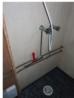
Vannrør ført inn på kjøkken har punktert vegg i våt sone.
