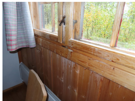
luftesjikt. Vannmerker på vindu og vegg under vindu pga kondensvann fra tak.
