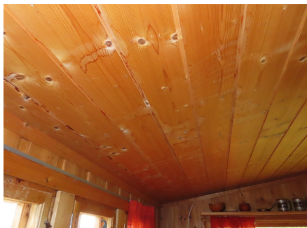
Vannmerker i himlinger pga manglende Kondenseringer/kondensvann/lekkasje.
