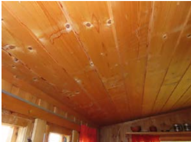
Vannmerker i himlinger pga manglende Kondenseringer/kondensvann/lekkasje.
