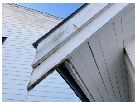
Begynnende råte på vindskie.
