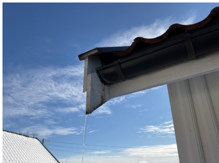
Lekkasje fra takrenner
