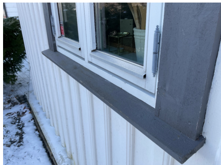
Kledning som stikker ned mot vannbrett.
