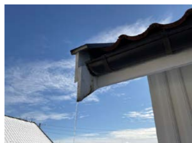
Lekkasje fra takrenner
