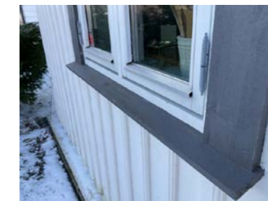
Kledning som stikker ned mot vannbrett.
