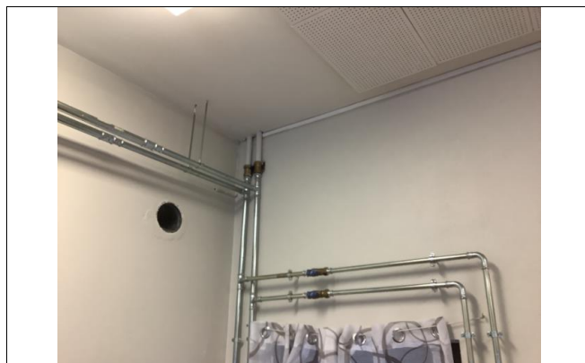
Nyere røropplegg for vannbåren varme.
