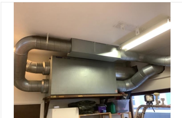
Ventilasjon i verksted i 1. etg.
