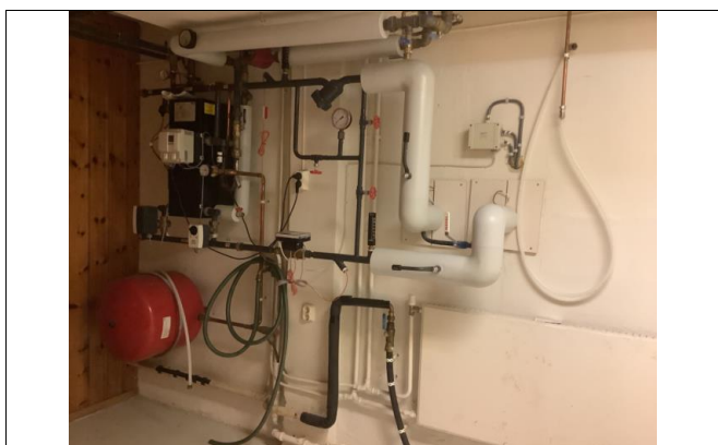
Tekniske installasjoner for vannbåren varme i kjeller.
