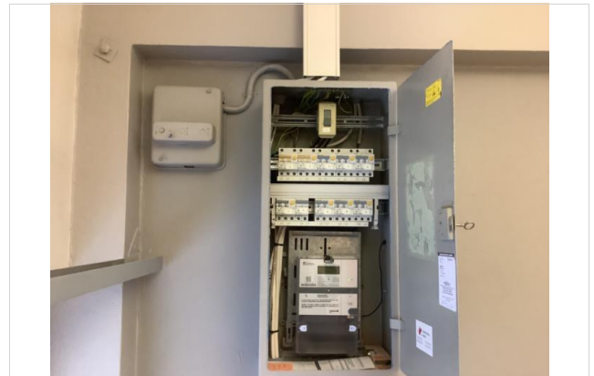
El-anlegg/sikringsskap i 2. etg.
