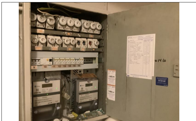
Sikringsskap i kjeller.
