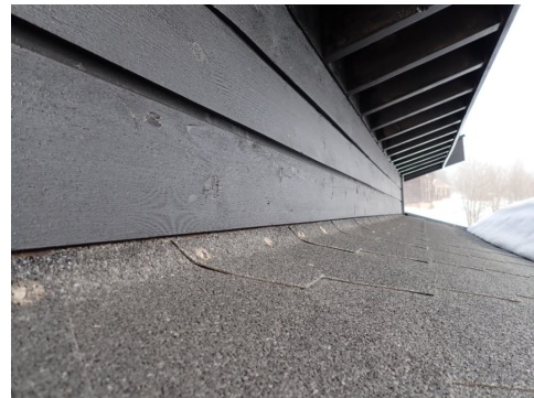
Viser overgang tak/yttervegg uten beslag.
