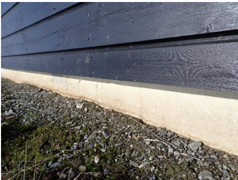
Viser utildekket plastisolasjon (isopor).
