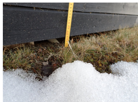
Viser liten avstand fra kledning til terreng (< 5 cm).
