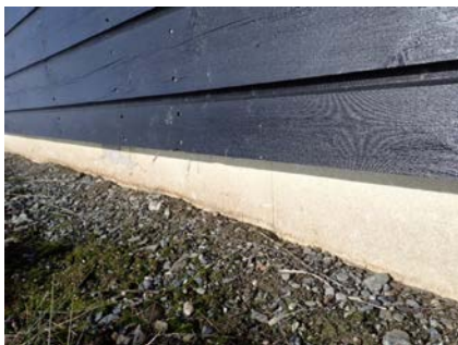
Viser utildekket plastisolasjon (isopor).
