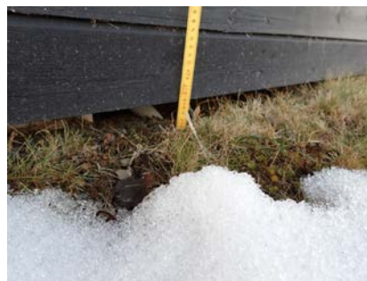
Viser liten avstand fra kledning til terreng (< 5 cm).
