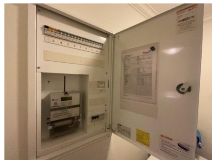
Sikringskap i separat del i underetasjen
