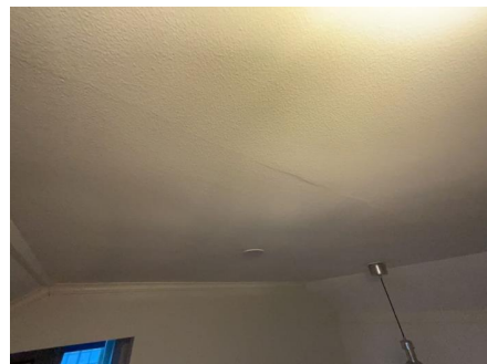
Synlig plateskjøt himling.
