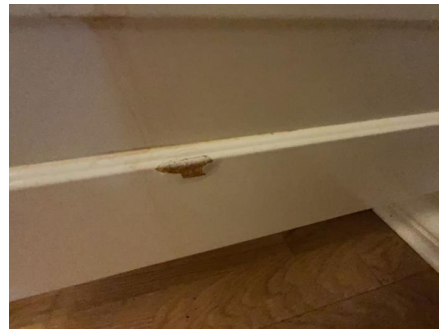
Lokal skade på front under oppvaskkum.
