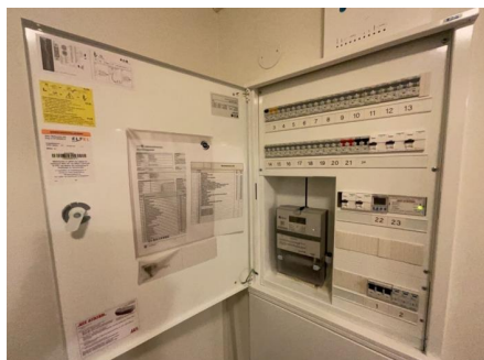
Sikringskapet er plassert i teknisk rom.
