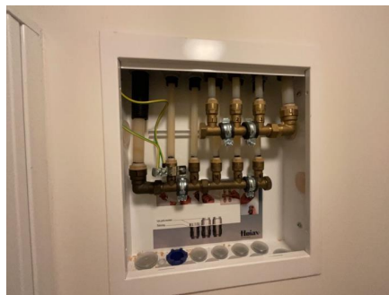
Vannfordelerskap i utleidel
