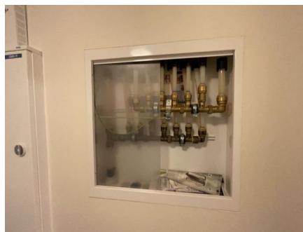
Vannfordelerskap i teknisk rom.
