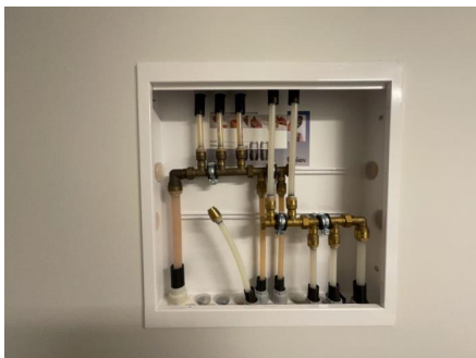
Vannfordelerskap i vaskerom
