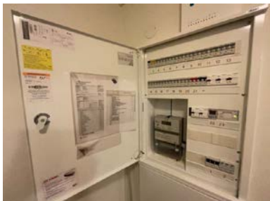
Sikringsskapet er plassert i teknisk rom.
