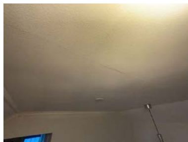
Synlig plateskjøt himling.
