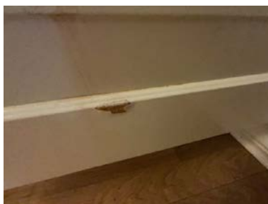
Lokal skade på front under oppvaskkum.
