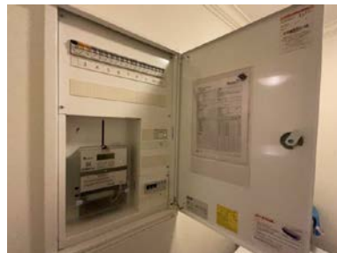
Sikringskap i separat del i underetasjen
