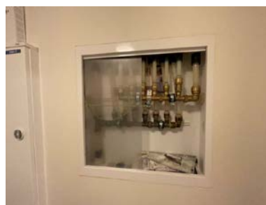
Vannfordelerskap i teknisk rom.
