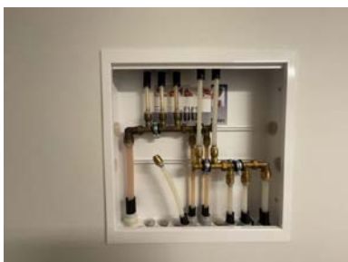
Vannfordelerskap i vaskerom
