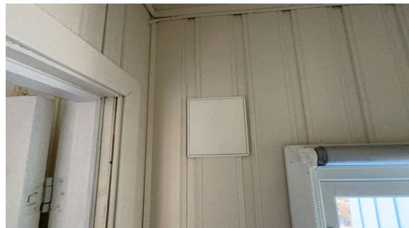
Eksempel på montert ventil i vegg.
