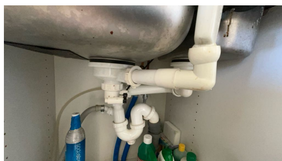
Del av rør til avløp.
