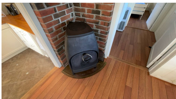
Montert ovn i stue.
