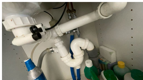
Del av rør til vann.
