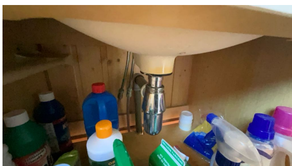
Del av rør til avløp.
