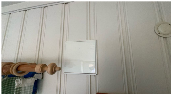
Eksempel på montert ventil i vegg.
