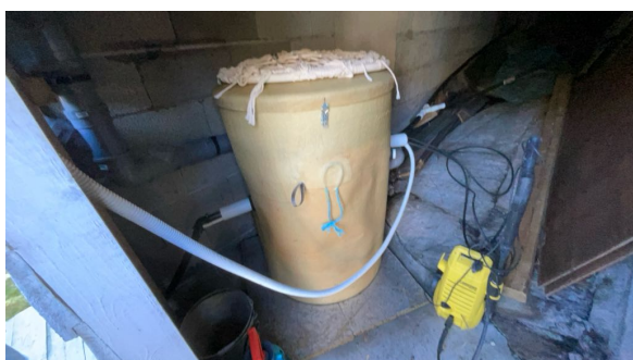
Tank med kværnepumpe.
