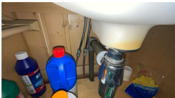
Del av rør til vann.
