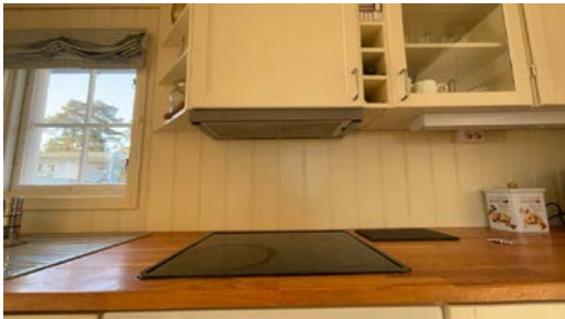
Montert avtrekk over steketopp.
