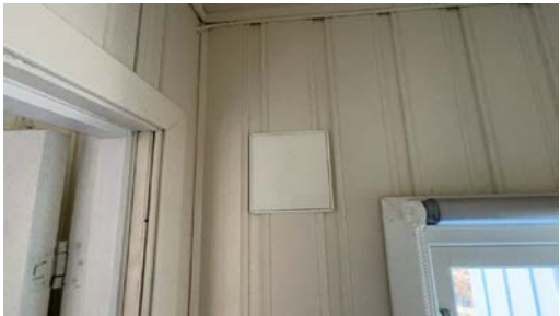
Eksempel på montert ventil i vegg.
