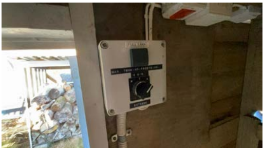
Styre strøm til pumpe.
