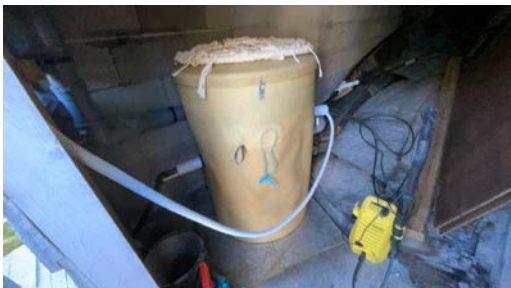
Tank med kværnepumpe.
