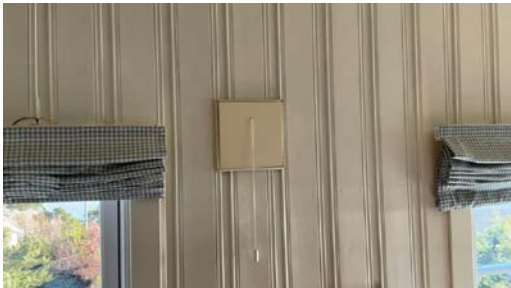
Eksempel på montert ventil i vegg.
