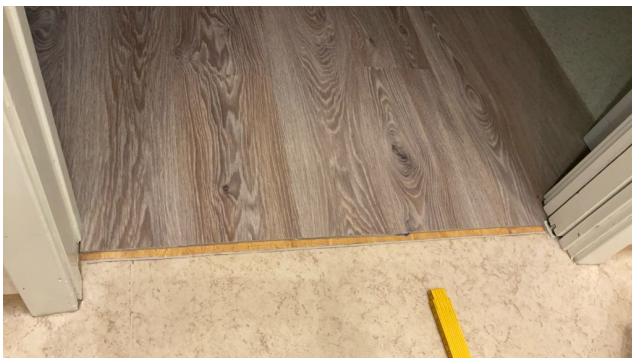
List i overgang vinyl til belegg mangler.
