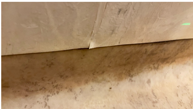
Utette skjøter i våtromstapet/belegg.
