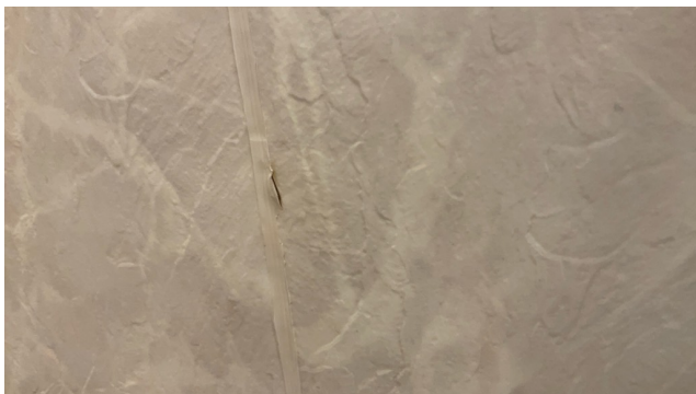
Utette skjøter i våtromstapet/belegg.
