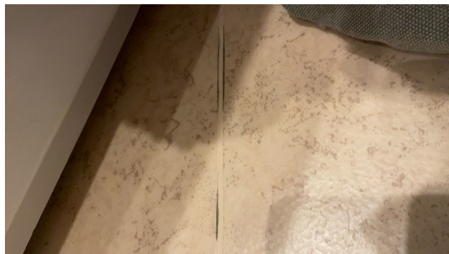
Sprekker i belegg
