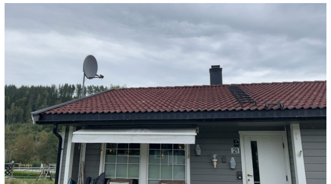
Eksempel på at snøfangere mangler.
