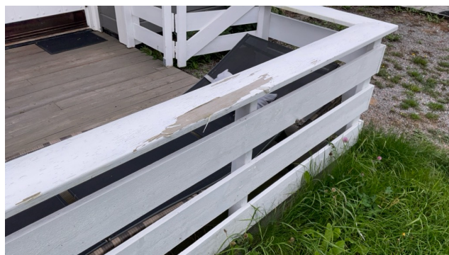
Eksempel på avflassing av maling på rekkverk.
