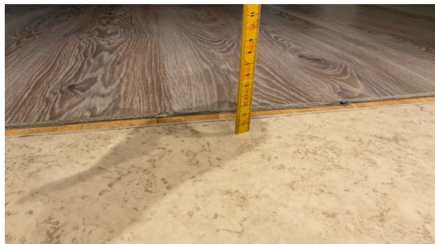
Det er målt 5,5cm på gulv ved dør.
