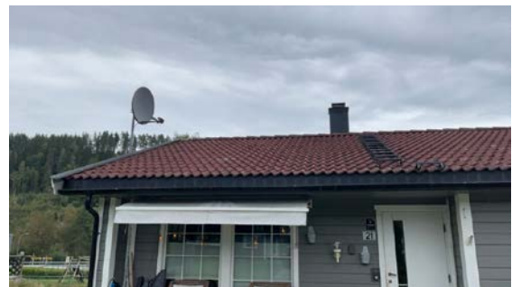
Eksempel på at snøfangere mangler.
