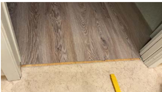
List i overgang vinyl til belegg mangler.
