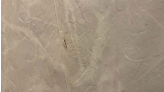
Utette skjøter i våtromstapet/belegg.
