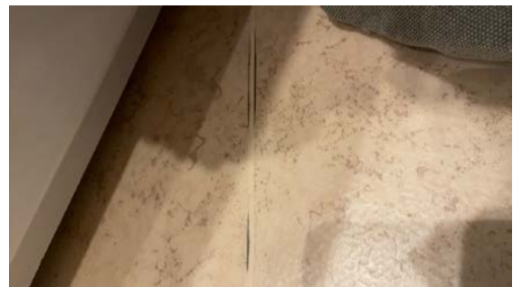
Sprekker i belegget
