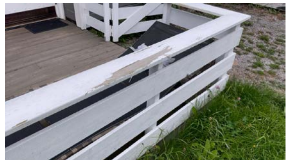
Eksempel på avflassing av maling på rekkverk.
