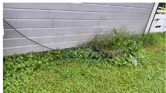
Eksempel på at terreng går opp til kledning.
