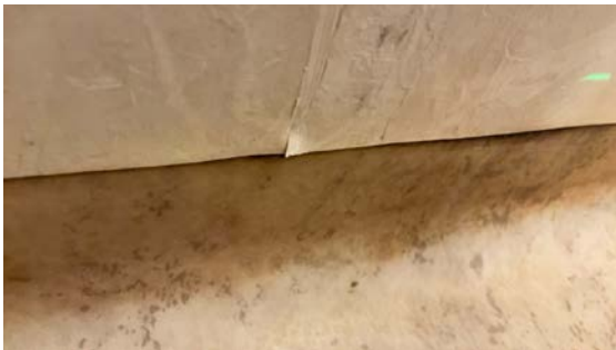
Utette skjøter i våtromstapet/belegg.
