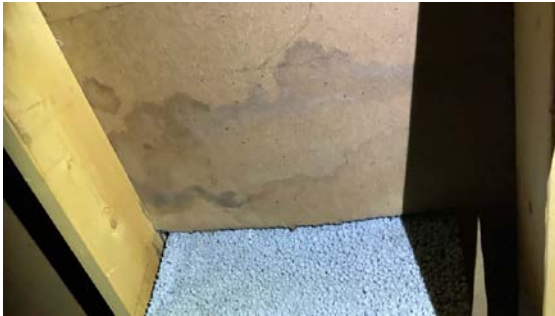
Eksempel på fuktskjolder i undertak ved pipe.
