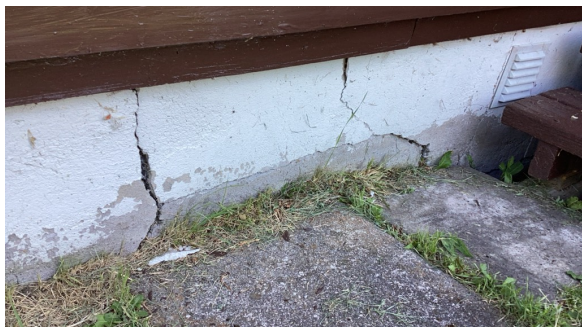
Eksempel på sprekker i grunnmur.
