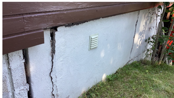
Eksempel på grunnmur som heller utover.
